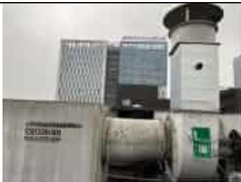
2#排气筒及活性炭箱
