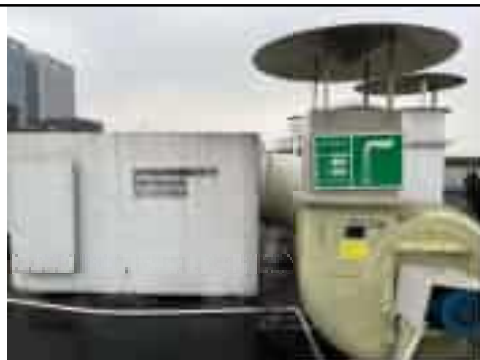
4#排气筒及活性炭箱
