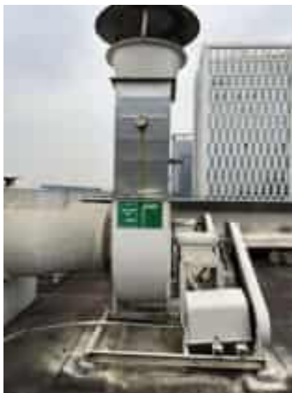
5#排气筒及活性炭箱
