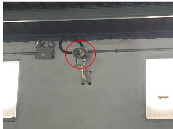
危废暂存间内部视频监控
