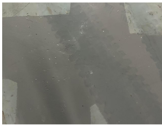
危废暂存间防渗地坪设施
