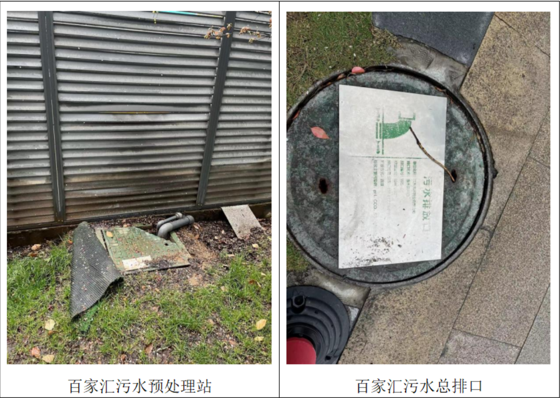
图 3-1 污水处理站及污水排放口图片
