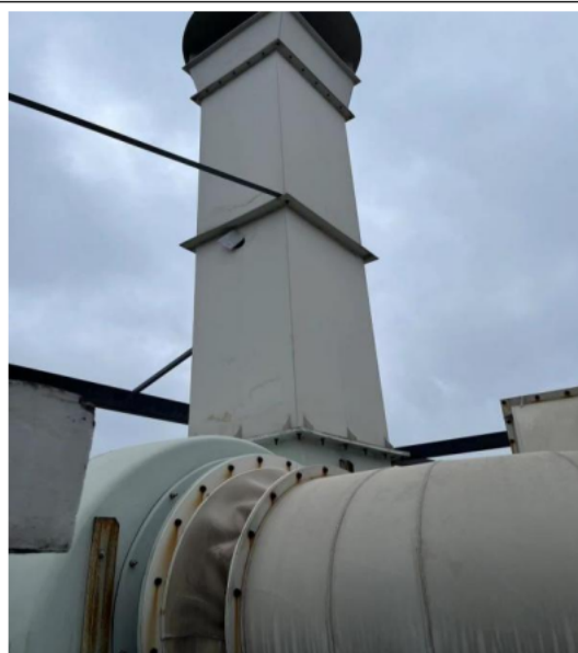
活性炭吸附装置及排气筒
